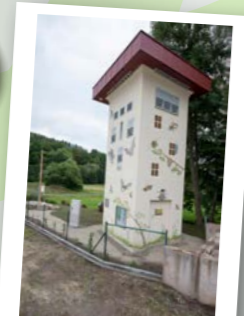
Blick auf das Trafohaus in Suhl mit naturnah umgestaltetem Außenbereich.
